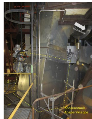
Abb. 12: Kohlenstaub-Absperrklappe in Einbauposition
