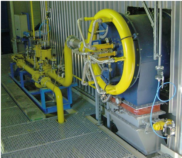
Abb. 2: Gasbrenner im Kraftwerk mit Sicherheits-Schnellschlussab- sperrsystem
