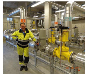
Abb. 9: Gasmisch-Station der Stadtwerke Stockholm
