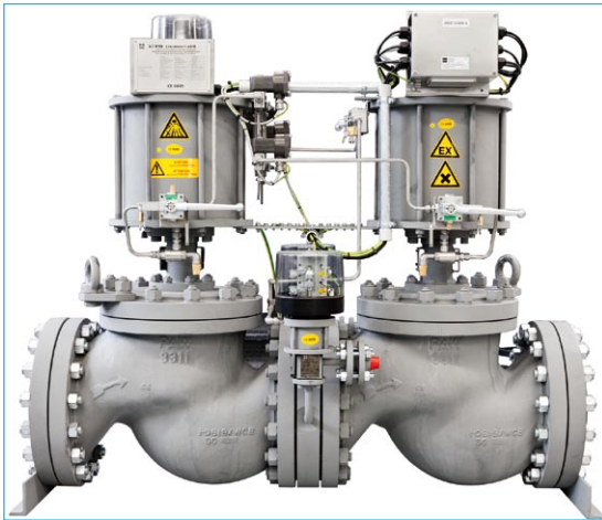
Abb. 3: Sicherheits-Schnellschlussabsperrung vor Gasturbine
